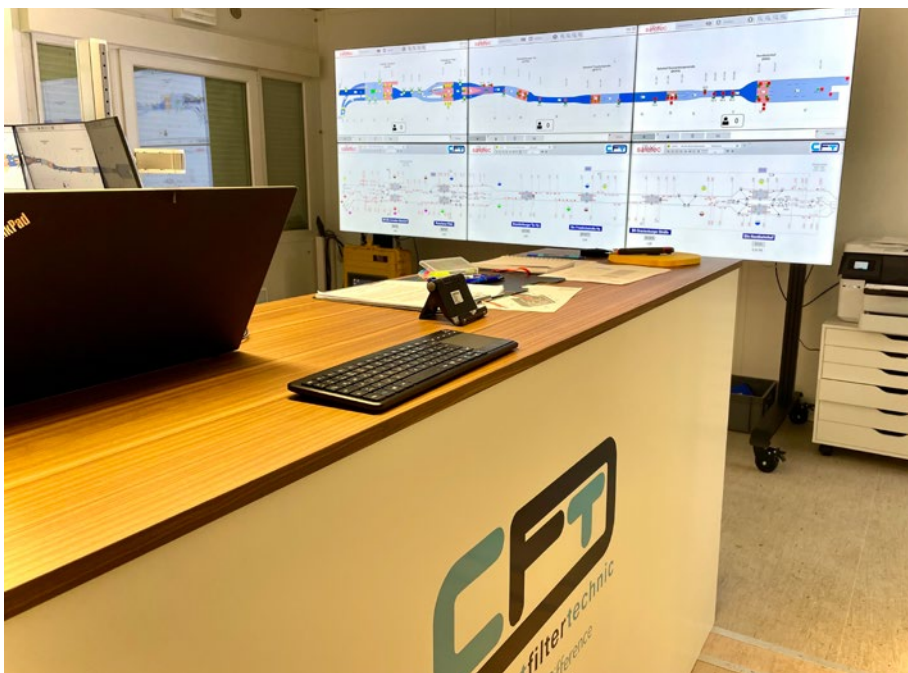
Abb. 6: Zentraler Leitstand zur Anzeige aller Messdaten, Steuerung aller Ventilatoren im Baufeld sowie Darstellung der Personenortung
