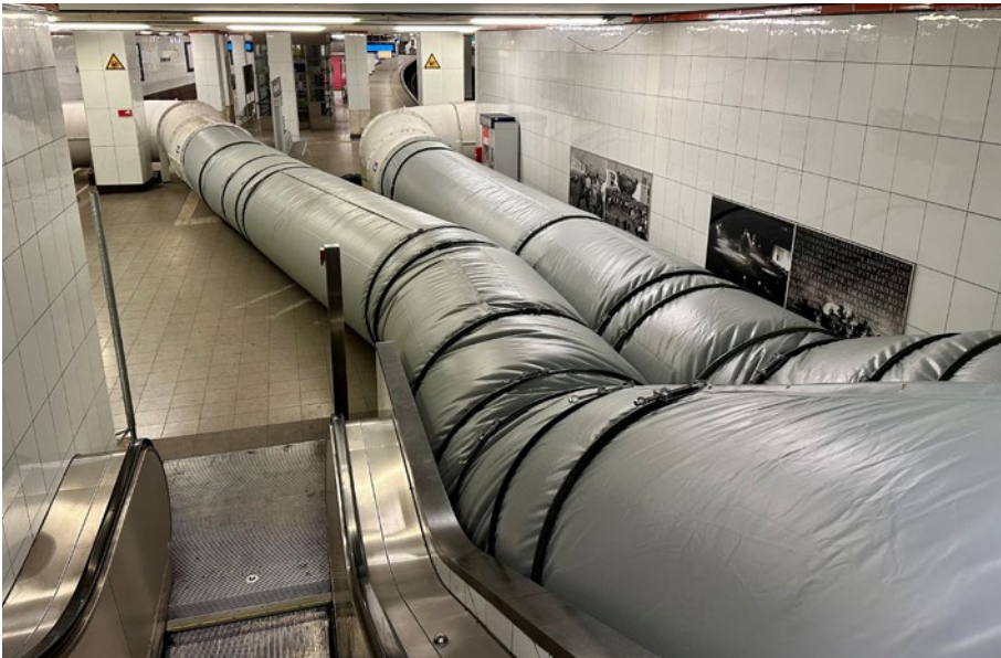
Abb. 3: Luttentour für aktive Entlüftung über einen Kamin im Bahnhof Potsdamer Platz
