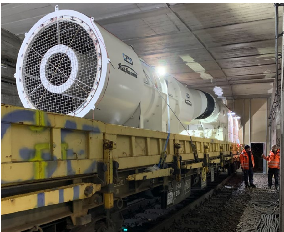
Abb. 5: CFT Trockenentstaubungsanlage mit Korfmann Axialventilator zur Reinigung staubhaltiger Abwetter aus dem Baufeld
