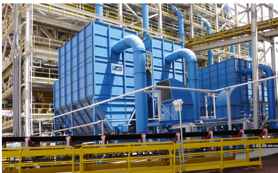
Installierte Deichmann Schlauchfilteranlagen für die Entstaubung einer Eisenerz-Separation in Mauretanien
